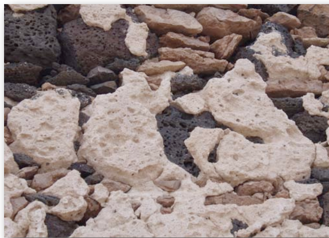
Restos de mortero de cal en un paramento. Fuerteventura, 2009
